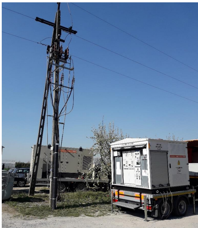
Rys. 3. Mobilna stacja transformatorowa z synchronizacją 15 kV PGE Dystrybucja 2019; opracowanie własne
