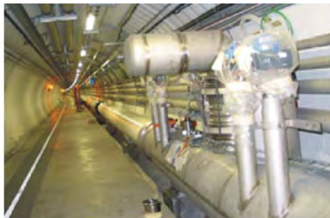
Rys. 7. Widok Głównej kriogenicznej Linii Dystrybucyjnej - QRL
