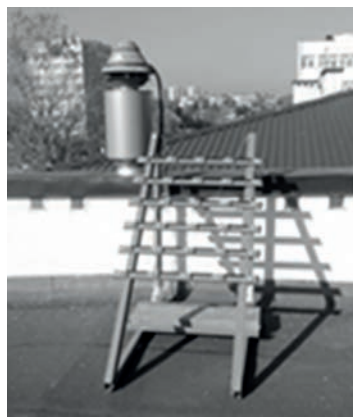
Widok stacji klimatycznej umieszczonej na dachu WPT
