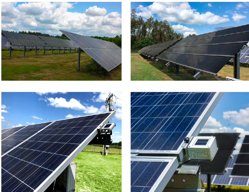
Ryc. 3.3. Instalacja eksperymentalna farmy fotowoltaicznej zawierająca moduły PV pierwszej i drugiej generacji
