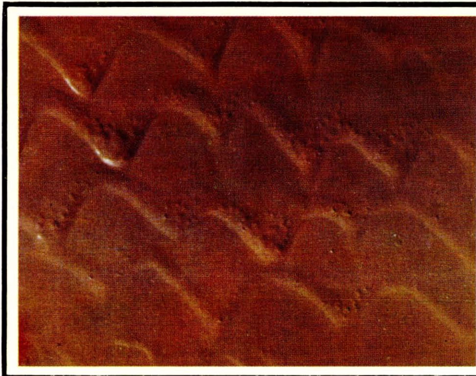
1. Grube zacieki w formie „firanek” z występującymi na nich spęcherzeniami
