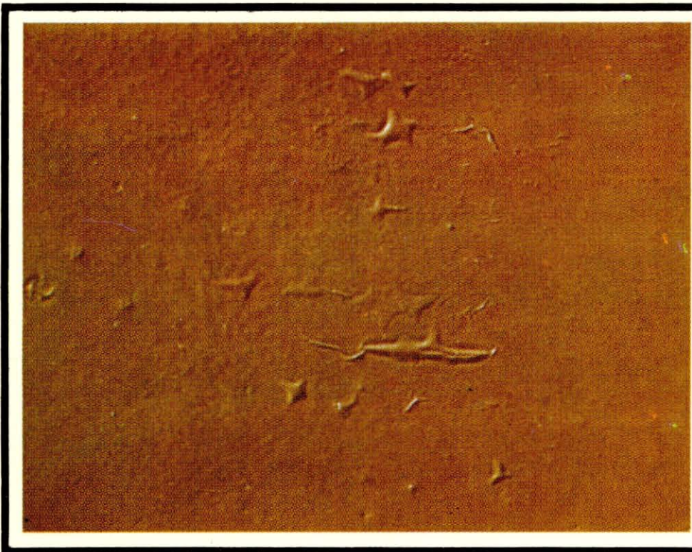
5. Duże spęcherzenia powłoki nawierzchniowej
