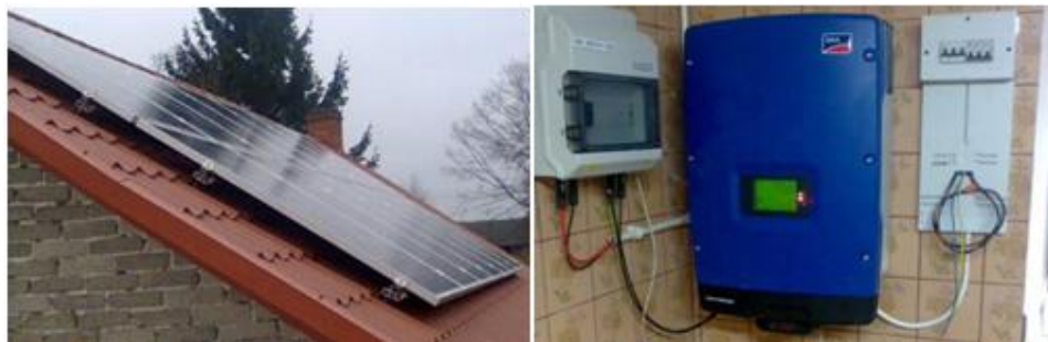
Rysunek 3.3.20. Widok pola paneli oraz instalacji wewnętrznej (www.sunwind.pl, 2015)
