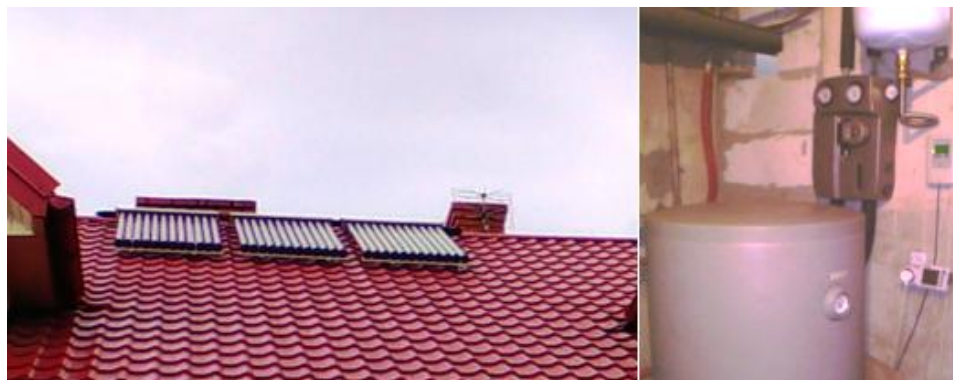
Rysunek 3.2.20. Widok pola kolektorów na dachu oraz części instalacji wewnętrznej
