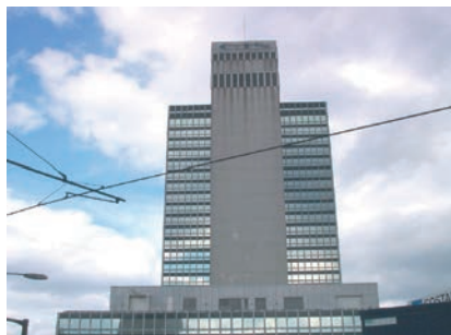
Rys. 18. Wadliwa fasada CIS Tower przed renowacją w 2005 roku [22]
