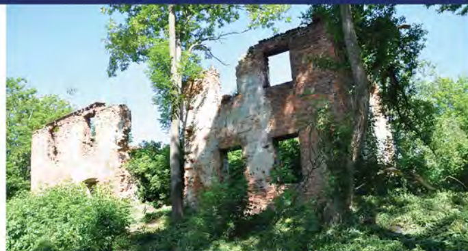
Fot. 7.19. Budynek w bardzo złym stanie technicznym.
