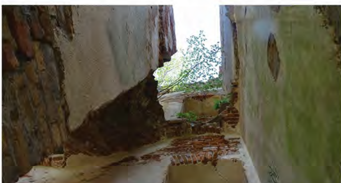
Fot. 1.22. Elementy spocznika klatki schodowej w stanie awaryjnym.
