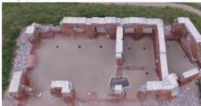
Fot. 6.24. Spękane zabezpieczenia na koronach murów.
