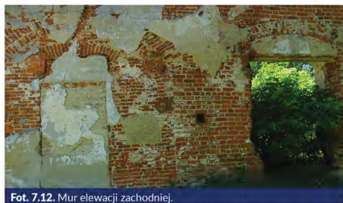
Fot. 7.12. Mur elewacji zachodniej.
