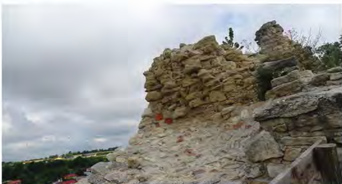
Fot. 5.9. Mur elewacji zachodniej.
