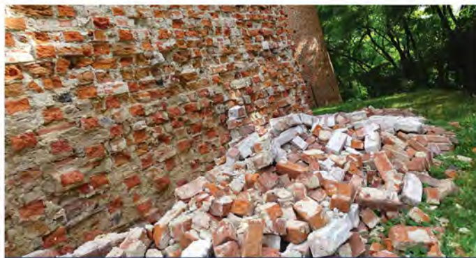
Fot. 3.22. Awaria muru północnego.
