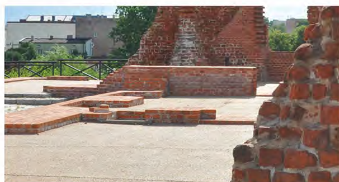
Fot. 6.31. Zacieki solne na nowych i starych murach.
