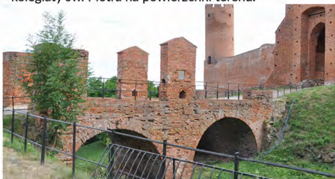
Fot. 3.29. Zniszczony XVIII-wieczny most ceglany.
