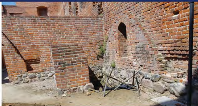
Fot. 2.25. Niezabezpieczony wykop w Domu Dużym.
