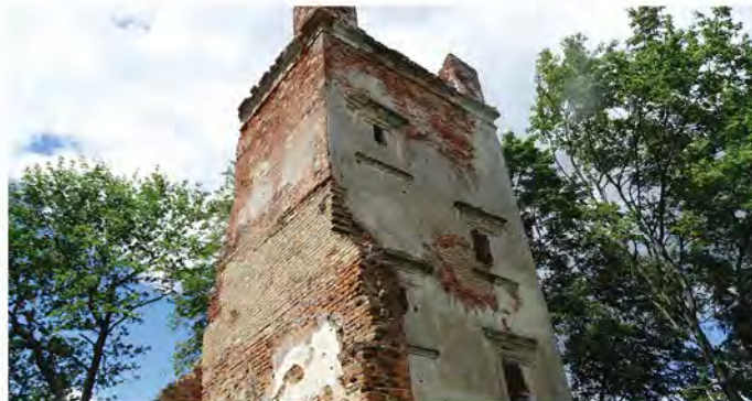
Fot. 1.21. Uszkodzone elementy murowe i dekoracyjne.
