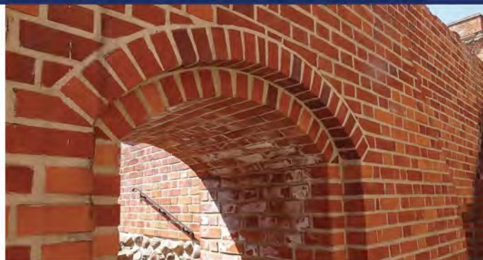
Fot. 2.26. Wykwity solne na nowych murach w Domu Dużym.
