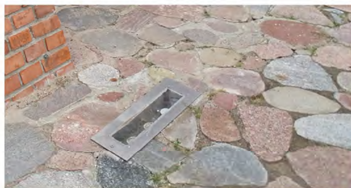
Fot. 6.33. Zniszczone oświetlenie na opasce.
