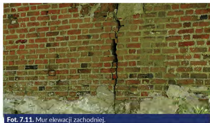
Fot. 7.11. Mur elewacji zachodniej.
