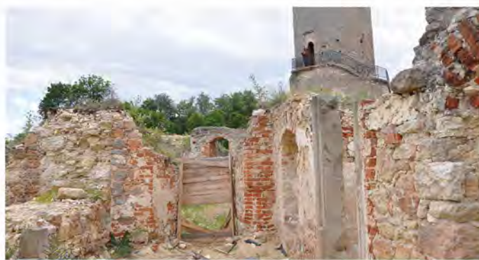
Fot. 4.17. Niezabezpieczone relikty murów.
