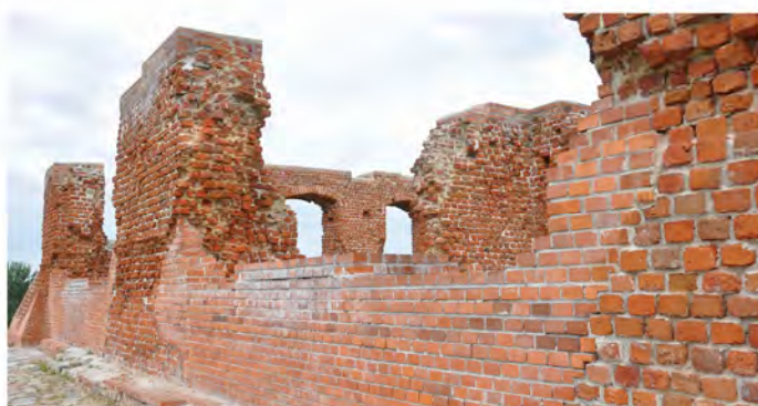
Fot. 6.30. Zacieki solne na murze.
