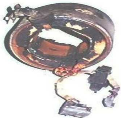
Rys. 5.17. Uszkodzenie stojana w postaci przegrzania uzwojenia
