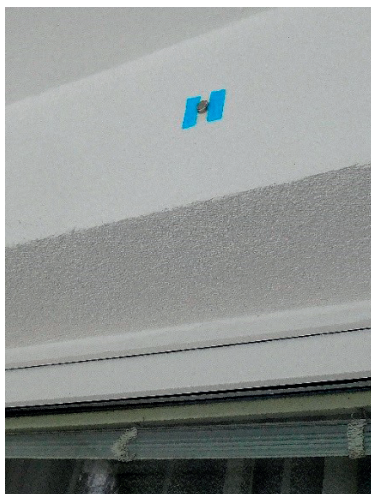
Rys. 9.15. Rejestrator temperatury na nadprożu, mieszkanie nr 4, Lublin.
