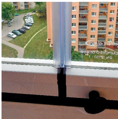
Rys. 9.6. Uszczelki międzyszybowe w obudowie balkonu, mieszkanie nr 1, Zamość.
