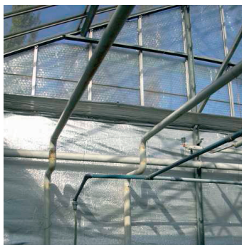
Rys. 13. Ekran odbijający promieniowanie słoneczne zainstalowany na przegrodzie północnej szklarni
