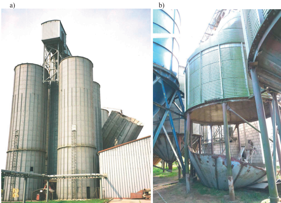
Rys. 7. Silosy z blachy falistej po awarii rozpoczętej oberwaniem się leja [9]: a) silos na śrutę sojową wg rys. 3, b) silos na zboże K850/2 wg rys. 4
