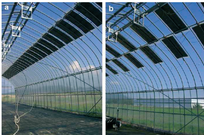
Rys. 18. Moduły fotowoltaiczne zamontowane na połaci dachu szklarni w układzie liniowym (a) i szachownicowym (b) [19]
