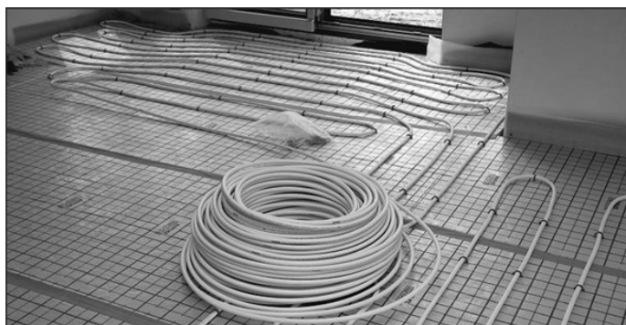
Rys 7. Przykład instalacji z rur polibutylenowych [20]
