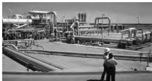
Rys. 2.44. Instalacje geotermalne w Kalifornii, USA
