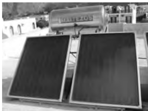
Rys. 2.38. Kolektory słoneczne do podgrzewania wody (Grecja, czasy obecne)
