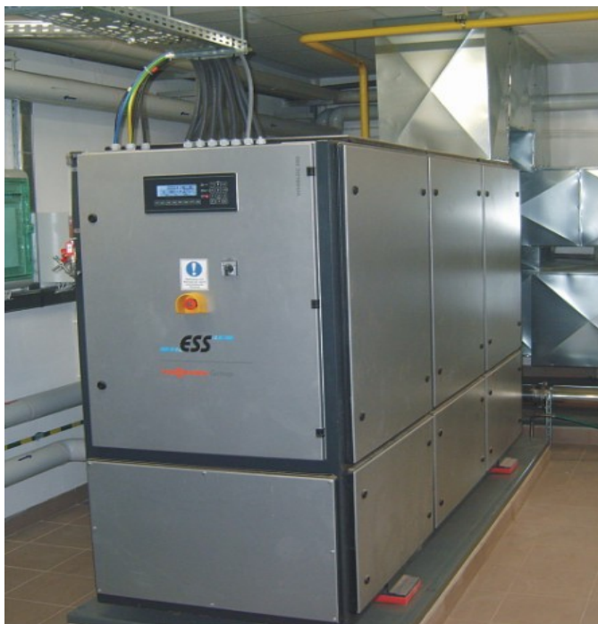
Rys. 1. Widok kotłowni i agregatu kogeneracyjnego 55 kW w minicentrum w Paniówkach
