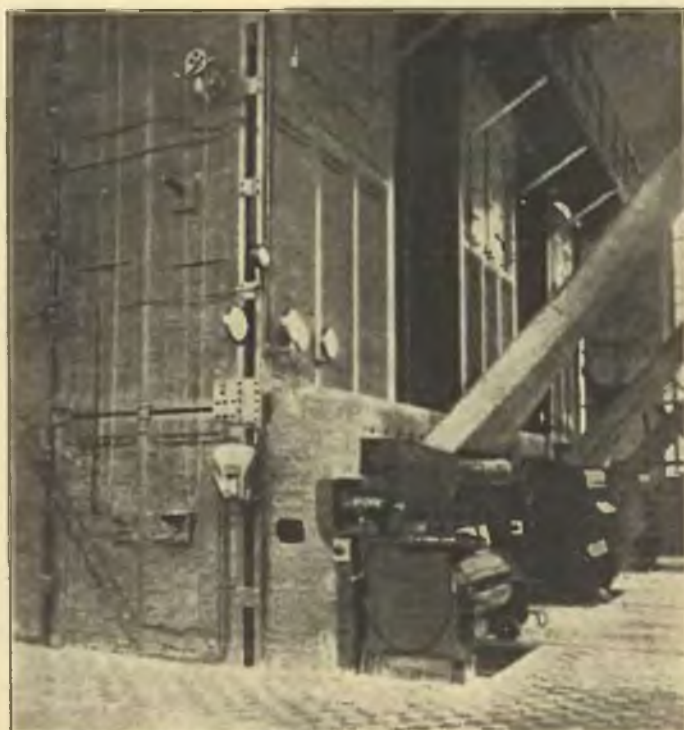
Kompletna instalacja kotłowni w wykonaniu, fabr. H. Cegielski S. A. Poznań.
