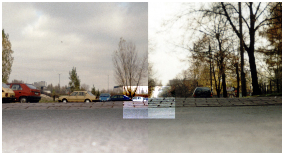
Rys. 5.11. Przykład progów zwalniających o różnej wysokości powodujących dodatkową emisję hałasu oraz problemy związane z drganiami
