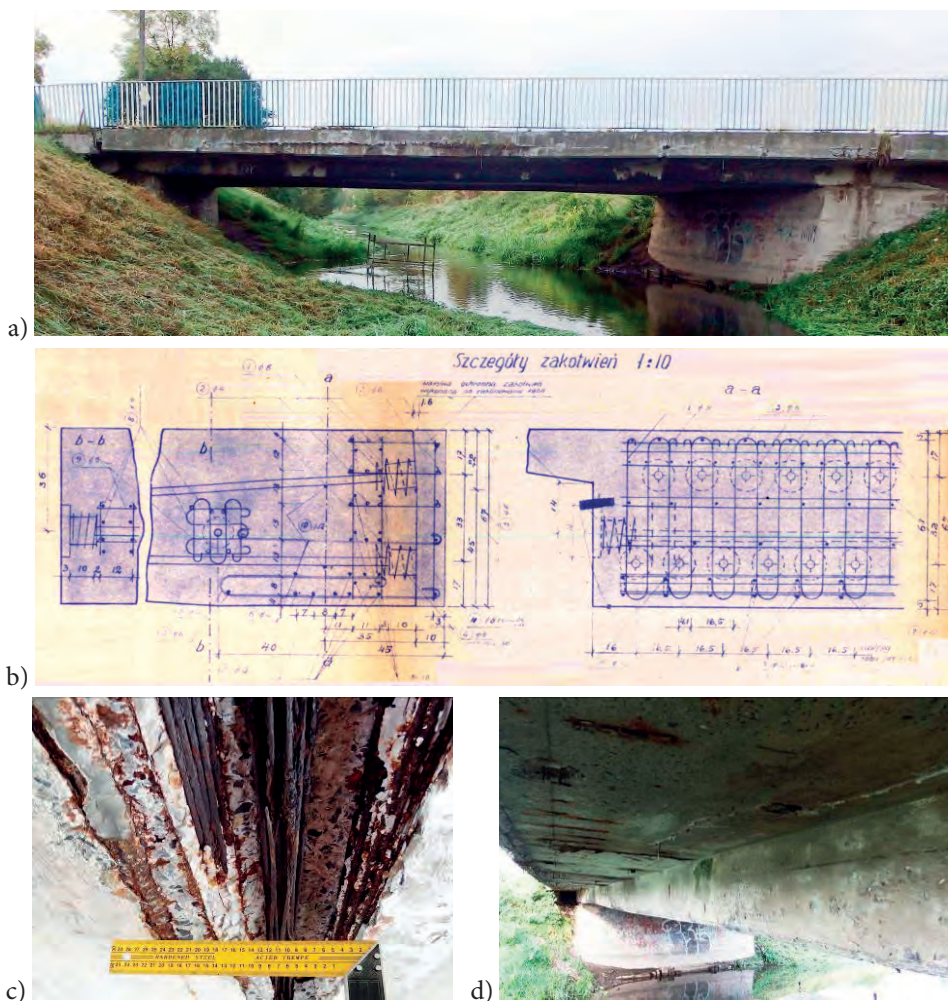
II. 17. Sprężony most betonowy nad Czarniejówką w ciągu ul. Pawiej a) widok z boku b) fragment dokumentacji projektowej (dzięki uprzejmości Krzysztofa Gnypa) c) korozja drutów kabli sprężających d) korozja na spodzie wspornika, fot. SLK (2015).
