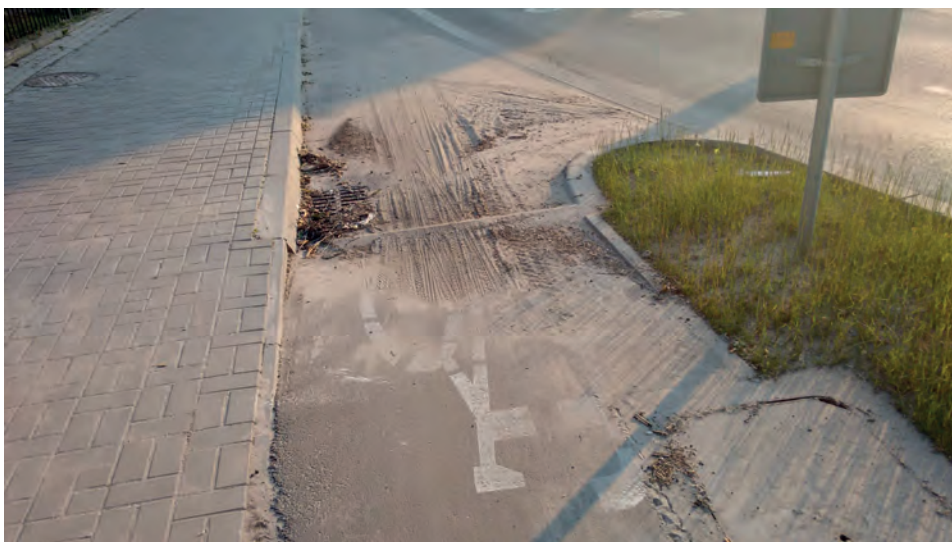
II. 4. Zła lokalizacja kratki ściekowej, fot. autor
