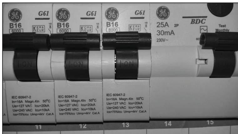
Rys. 9.2. Wyłączniki instalacyjne i wyłącznik różnicowoprądowy jednofazowy
