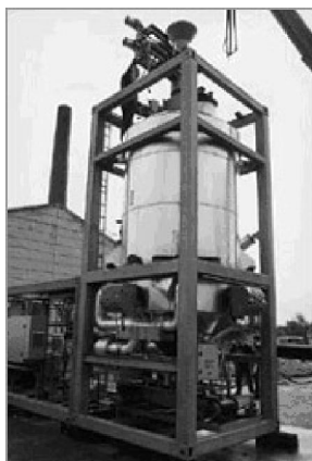
Rys. 6 Piec opancerzony do unieszkodliwiania zbędnych środków bojowych Przedsiębiorstwa Winderickx Sp. z o. o. [10].
