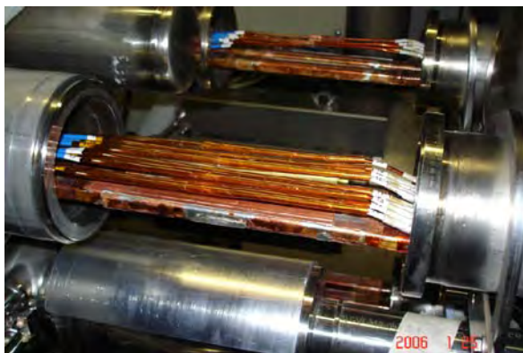
Rys.4.2.21. Połączenie szyn prądowych głównych elektromagnesów oraz elektromagnesów korekcyjnych w tunelu
