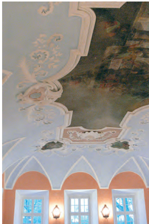
Fot. 3. Przykład wnętrza, w którym ściany wymalowano współczesnymi farbami gubiąc jego autentyczność, zacierając klimat dawności. Prawem kontrastu cenne malowidło na sklepieniu zostało zdegradowane do roli brudnej, nieciekawej plamy. Wywołane takim kontrastem zjawiska wychodzą poza sferę subiektywnie odczuwalnych doznań estetycznych, lecz poprzez złamanie reguł fizjologii widzenia – zbyt duże napięcia walorowe – wręcz uniemożliwiają prawidłową percepcję malowidła.
