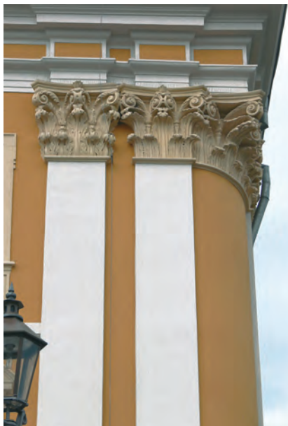
Fot. 11. Fragment fasady – prace zostały zrealizowane współczesnymi materiałami i metodami. Przesadnie gładkie, wyprowadzone na ostry kancik tynki pokryto farbami na bazie bieli tytanowej, co dało efekt plastikowej folii na tekturowym pudełku. Fasada jest głucha i martwa. Obiekt stracił walory plastyczne – został spłaszczony, pozbawiony gry światłocienia na charakterystycznych nierównościach barokowego tynku. Stracił autentyczność i wiarygodność jako zabytek, bo charakter powierzchni, jej faktura i kolor informuje oglądającego, że jest to budowla współczesna o formach zaczerpniętych z architektury historycznej.
