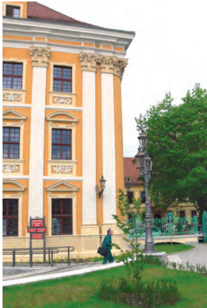
Fot. 10. Polska – fasada zabytku zamęczonego odnowieniem.
