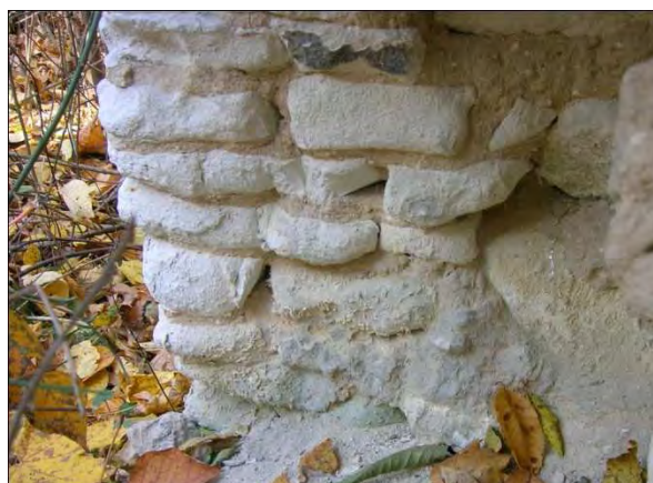
Rys. 3.22 Korozja solna muru z kamienia wapiennego
