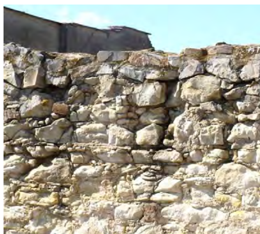
Rys. 3.19 Zniszczenia korony murów z kamienia spowodowane działaniem wód opadowych
