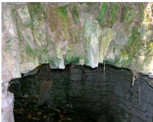
Rys. 3.23 Kolonie glonów na przewilgoconym murze z cegły ceramicznej
