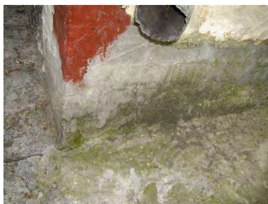
Rys. 13.6 Zawilgocenie ściany w pobliżu rury spustowej
