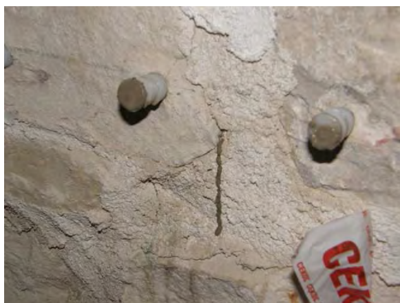
Rys. 10.20 Wyciek zaprawy trasowej z muru
