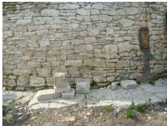
Rys. 13.12 Przyziemie z widocznymi ubytkami zaprawy spoin
