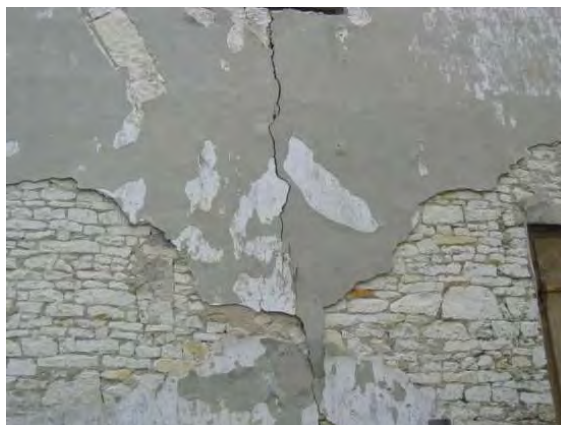
Rys. 13.20 Pęknięcie na elewacji wschodniej
