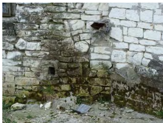
Rys. 13.15 Zawilgocenie przyziemia, obecność korozji biologicznej.
