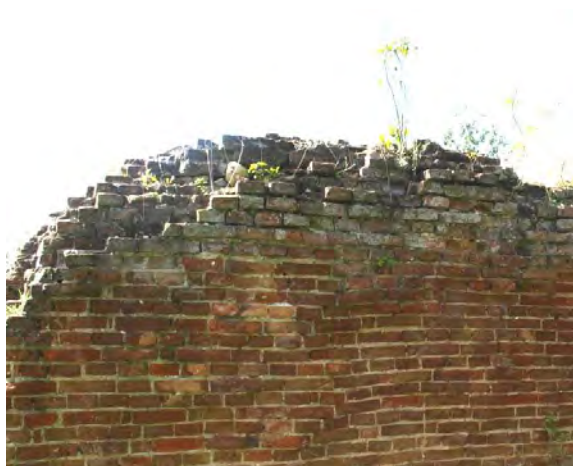
Rys. 3.18 Zniszczenia korony murów z cegły ceramicznej spowodowane działaniem wód opadowych
