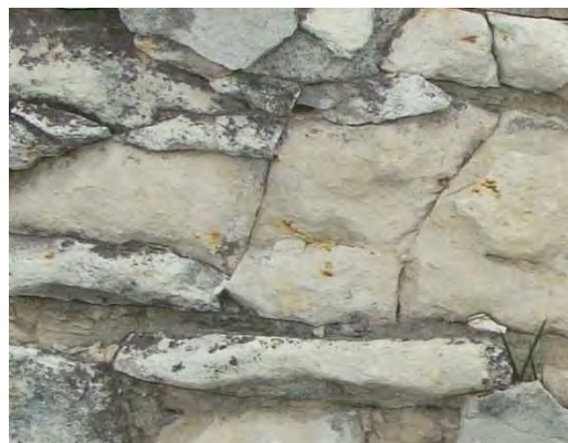
Rys. 13.14 Spękania pojedynczych kamieni.
