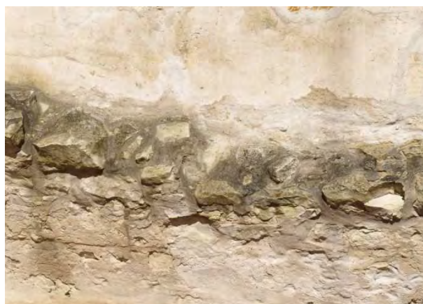
Rys. 3.21 Korozja solna tynków w murze z kamienia wapiennego
