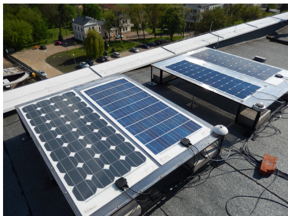
Ryc. 7.11. Moduły fotowoltaiczne z czujnikiem napromieniowania SR12 na dachu budynku Wydziału Mechanicznego Politechniki Lubelskiej
