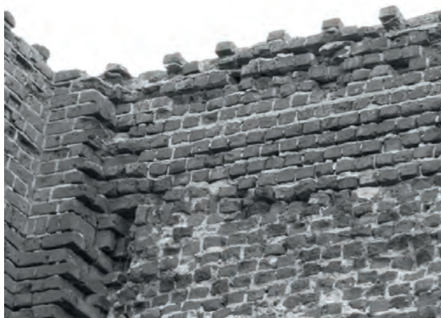
Fot. 5. Liw. Zamek. Zdegradowana cegła współczesna przy koronie muru Domu Dużego – 2011 r.
