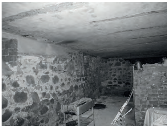
Fot. 8. Liw. Zamek. Pomieszczenia piwnic, widoczna korozja stropu oraz zawilgocenie ścian piwnic Domu Dużego – 2011 r.
