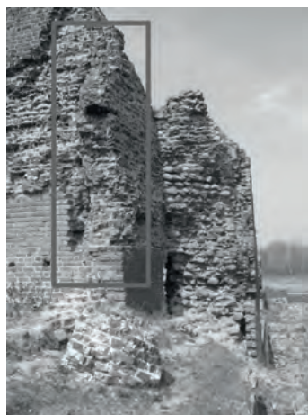
Rys. 15. Odspojona część muru wieży wysokiej w narożniku wschodnim, kwiecień 2012 r.
