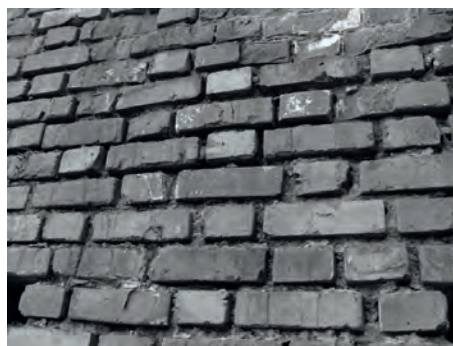
Rys. 15. Mur zrekonstruowany, z wyraźnymi ubytkami zaprawy, kwiecień 2012 r.
