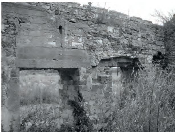
Fot. 14. Ćmielów. Zamek. Mury przedzamcza. Żelbetowe wypełnienia muru w skrzydle zachodnim – 2011 r.
