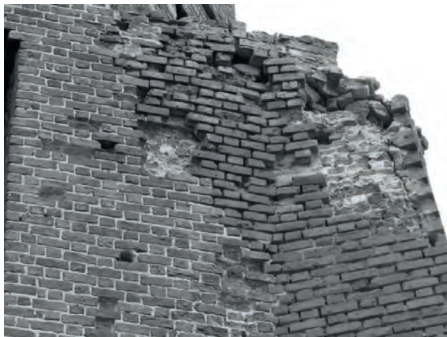
Fot. 7. Liw. Zamek. Uszkodzenia szkarpy od strony południowo – zachodniej, budynek wieży – 2011 r.
