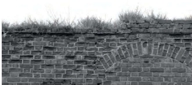
Rys. 10. Izolacja koron murów dziedzińca wykonana w latach 1969-1971, czerwiec 2011 r.
