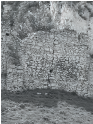
II. 8. Pęknięcie w murze kurtynowym zamku średniego, lipiec 2011.
