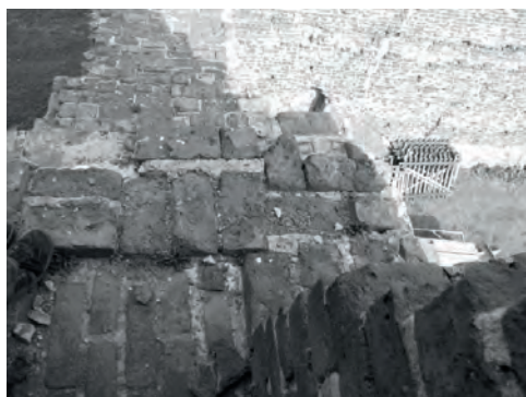
Rys. 11. Zniszczenia korony muru, wykruszenia cegły, spowodowane brakiem zabezpieczeń oraz złym odprowadzeniem wody opadowej z wieży.
