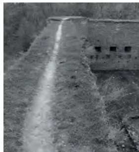
Rys. 2. Wydeptana na koronie murów ścieżka umożliwia gromadzenie i miejscowo wnikanie wody.
