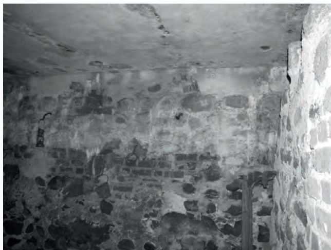
Fot. 9. Liw. Zamek. Krystalizujące sole na powierzchni ścian piwnic Domu Dużego – 2011 r.
