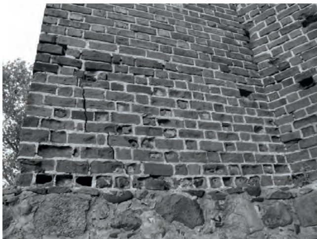
Fot. 4. Liw. Zamek. Uszkodzenia lica muru Domu Dużego – 2011 r.
