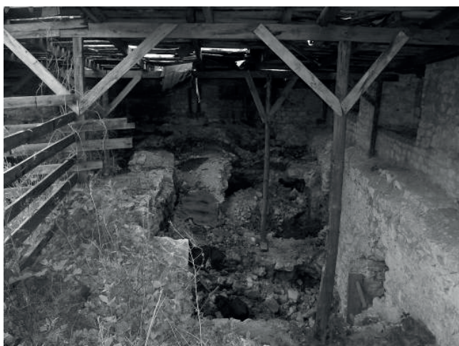
Fot. 11. Janowiec. Zamek – wybudowa północna, (pomieszczenia czeladne) stan awaryjny – 2011r.
