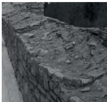
Rys. 17. Korona murów. Miejscowe uszkodzenia zaprawy oraz błędnie wykonany spadek.
