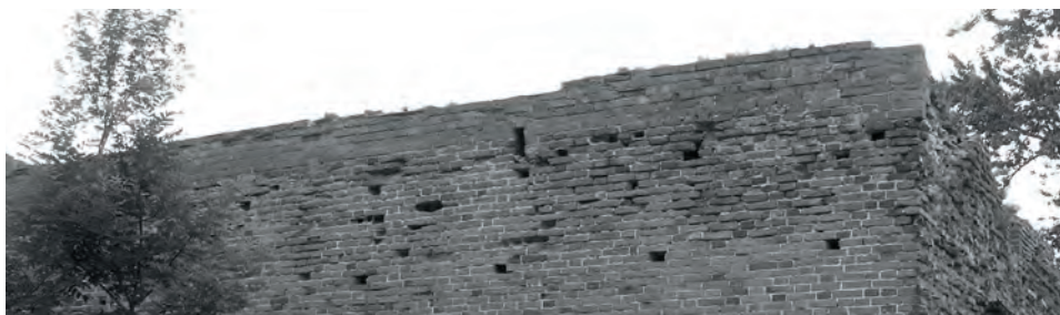
Rys. 22. Widok przemurowań wykonanych z cegły współczesnej na zaprawie mocniejszej od pierwotnej.
