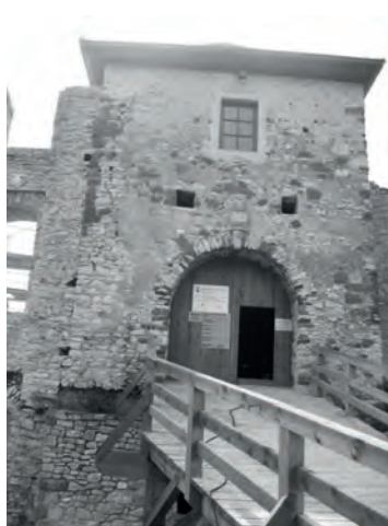
II. 11. Widok na budynek bramny od strony północnej, uszkodzenie lewego narożnika, lipiec 2011.
