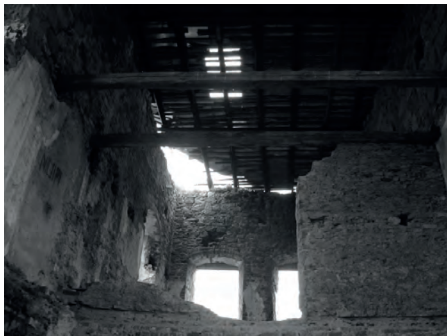
Fot. 10. Ćmielów. Zamek, budynek bramny. Awaryjny stan pokrycia dachowego – 2011 r.
