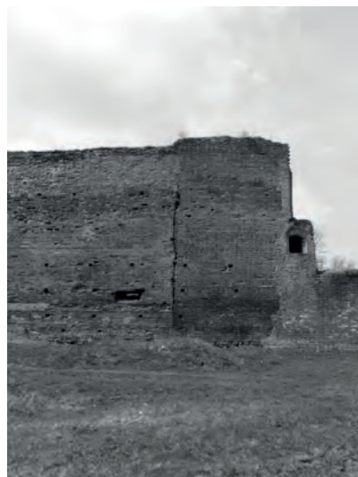
Rys. 12. Pęknięcie w północno-wschodnim murze gościńca po stronie zewnętrznej, kwiecień 2012 r.
