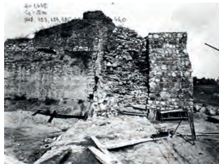
Rys. 13. Ta sama szczelina zamurowana podczas prac przeprowadzonych w latach 80 24 .
