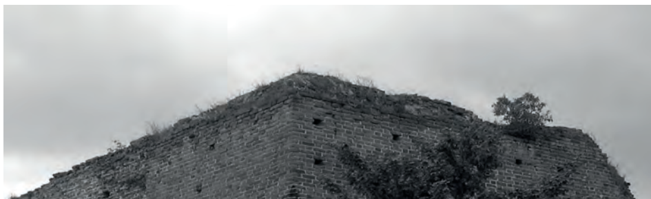
Rys. 21. Uszkodzenia koron w pasie warstwy nadmurowanej, porastanie zabezpieczonych koron roślinnością.
