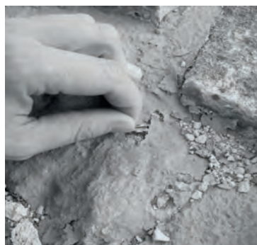
Rys. 18. Przemurowana korona murów z fragmentami spoin zabezpieczonymi preparatami hydrofobizującym. Uszkodzenia warstwy hydrofobizującej
