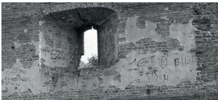
Rys. 13. Pozostałości tynków na ścianie południowej budynku mieszkalnego, czerwiec 2011 r.
