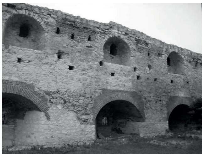
Fot. 9. Janowiec. Zamek – Północny muru obronnego. Zawilgocenie górnej części muru - 2011 r.
