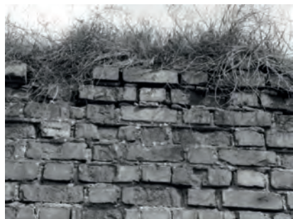
Rys. 3. Uszkodzenia współcześnie nadmurowanej korony.
