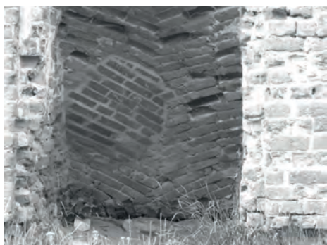
Rys. 8. Wyraźnie zaznaczone przemurowanie wykonane w latach 1969-1971, czerwiec 2011 r.
