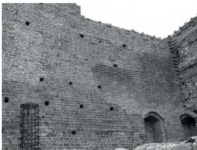
Fot. 6. Liw. Zamek. Brak przewiązania muru historycznego i współczesnego, ubytki spoin Domu Dużego – 2011 r.
