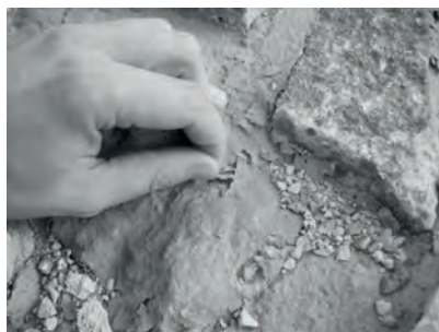
Il. 12. Zniszczona warstwa hydrofobowa korony ściany południowej, luty 2012.
