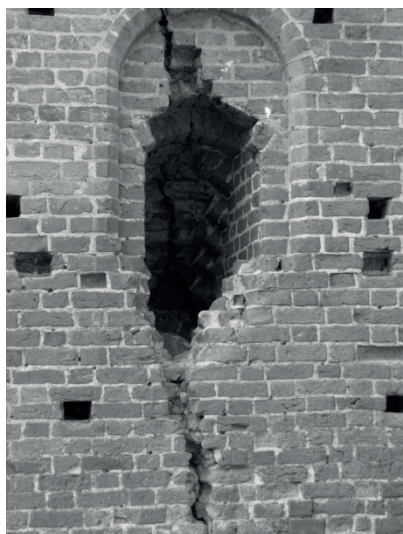
Rys. 11. Pęknięcie w północnym murze gościńca po stronie wewnętrznej, czerwiec 2011 r.
