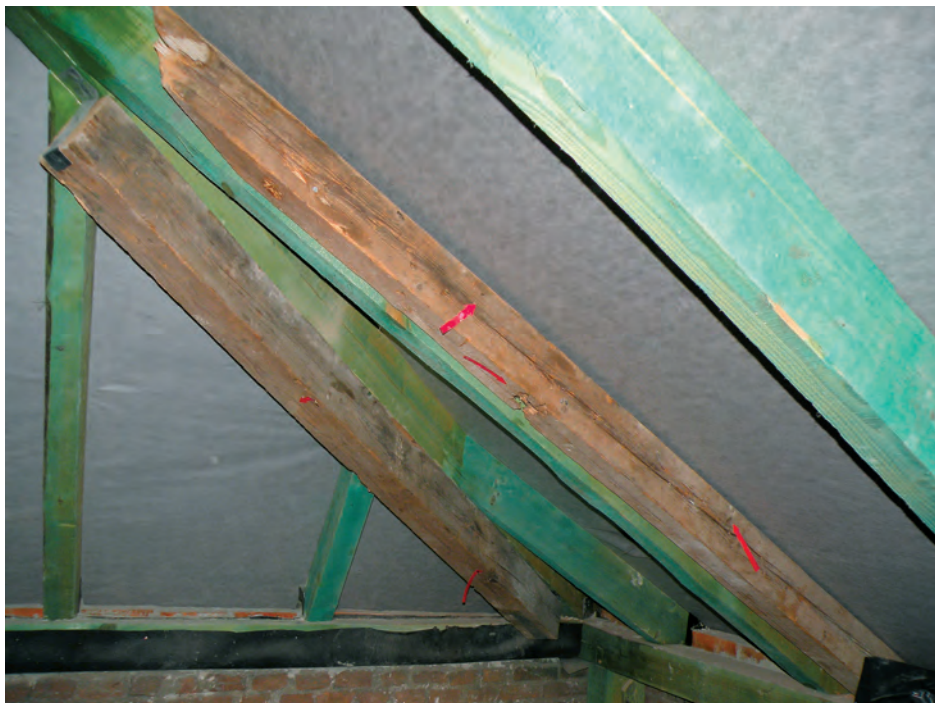
Fot. 3. Fragmenty pierwotnych krokwi.
