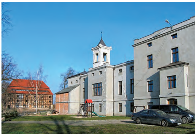
Fot. 2. Pałac w Galowicach, dramatyczny przykład docieplenia zabytkowej elewacji styropianem.
