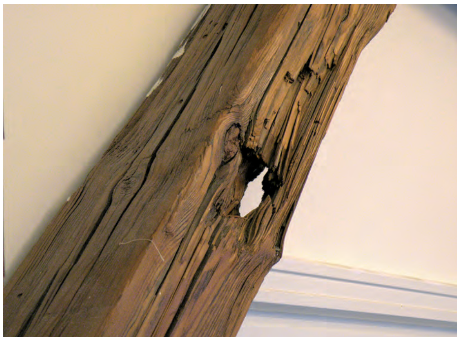
Fot. 8. Przestrzelina w mieczu konstrukcji drewnianej
