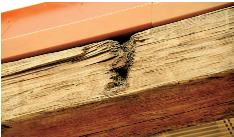
Fot. 12. Uszkodzenie odłamkiem drewnianej belki.
