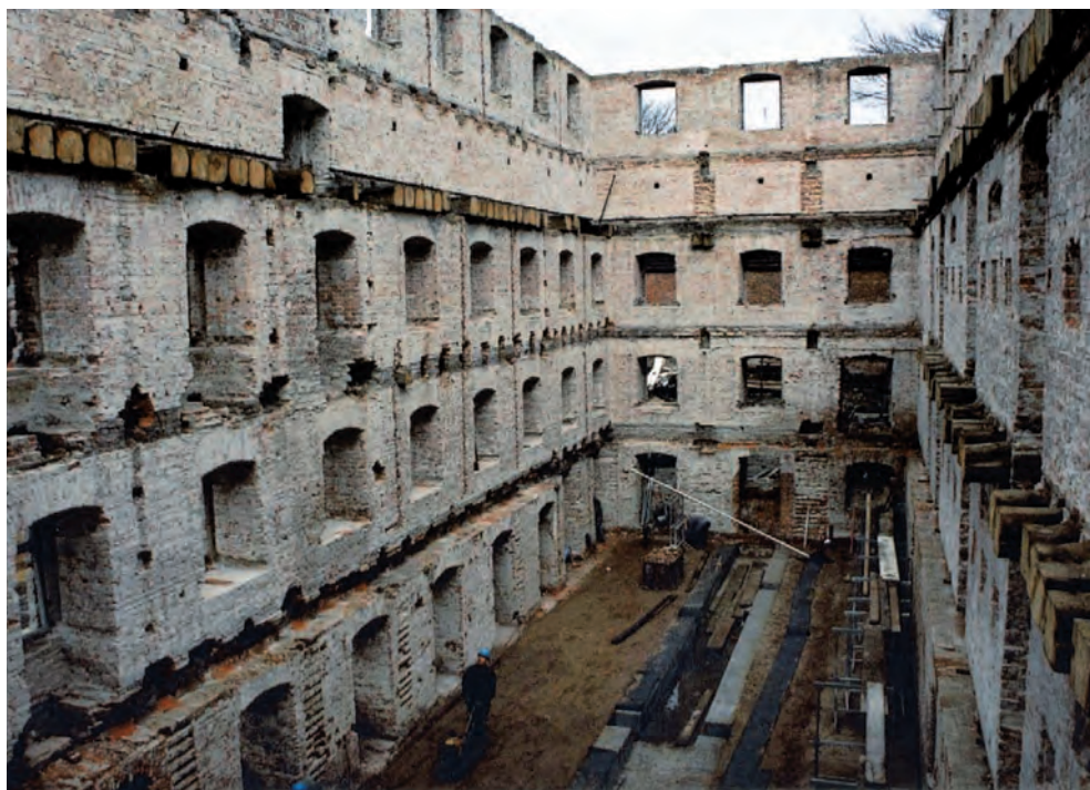
Il. 1. Budynek dawnych koszar z 1819–25 r. z wyburzonym całkowicie zabytkowym wnętrzem. Foto ze zbiorów MKZ – autorka M. Furmaniuk; Toruń.
