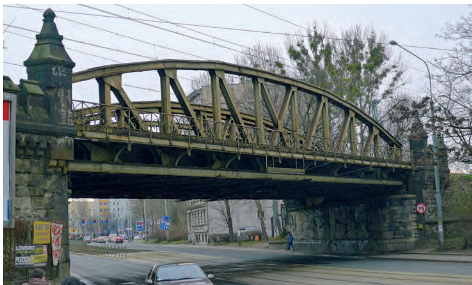
Fot. 1. Wiadukt kolejowy z 1885 r., Wrocław, ul. Grabieżyńska, stan sprzed rozbiórki – przykład zagrożenia zmianą technologii przy zachowaniu istniejącej funkcji. Przewidywana trasa „Pendolino” skłoniła inwestora i projektantów do usunięcia ze względów technologicznych nienowoczesnej, trudnej do przeliczenia konstrukcji nitowanej. Argument, że nowy pociąg przejeżdżać będzie przez Wrocław z taką samą prędkością co dotychczasowe, okazał się nieistotny. Na swoje nieszczęście, wiadukt wpisany był, jedynie, do ewidencji zabytków.
