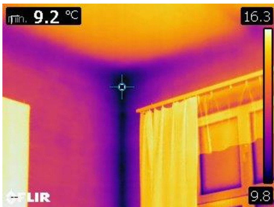
Rys. 6. Obraz termowizyjny wewnątrz przykładowego pomieszczenia
