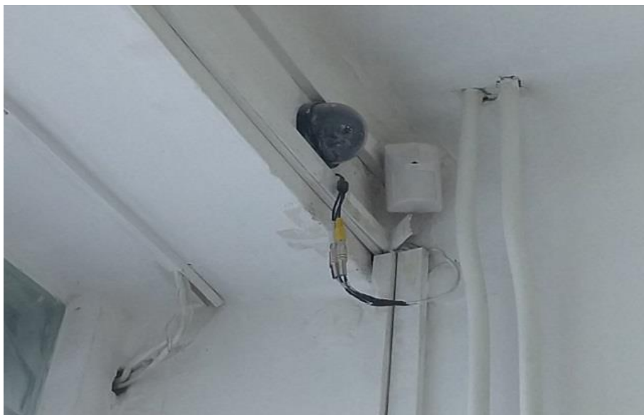
Rys. 2. Monitoring wraz z czujką alarmową
