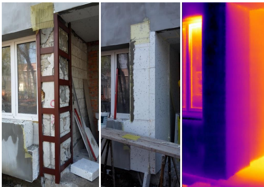
Rys. 1. Zdjęcia cyfrowe i termowizyjne elementu konstrukcyjnego budynku Studium Wychowania Fizycznego
