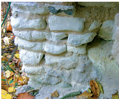
Rys. 9. Korozja solna muru z kamienia wapiennego.
