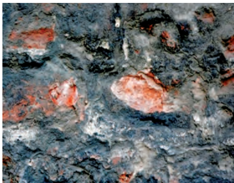
Fot. 2. Czarne, grube, zbite nawarstwienia przyczyniające się do dezintegracji cegły
