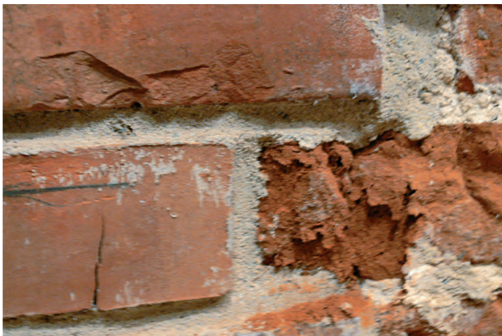
Fot. 17 Ogrzewanie wnętrza powodowało intensywne wysychanie cegły i niszczenie przez krystalizujące sole. Fot. B. J. Rouba
