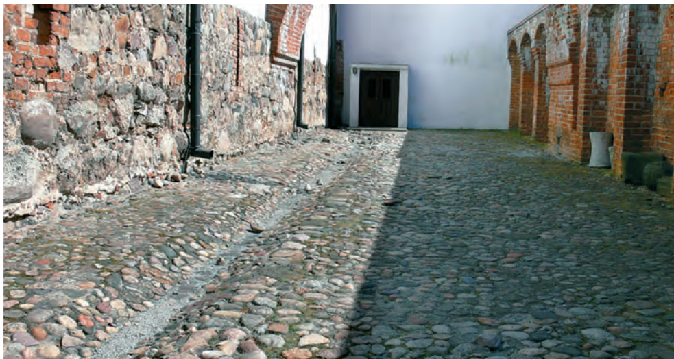
Fot. 4 Prawidłowo ukształtowane spadki i odpływy wody na dziedzińcu, ale wadliwie ułożony bruk – na zaprawie cementowej, uszczelniającej teren. Fot. B. J. Rouba
