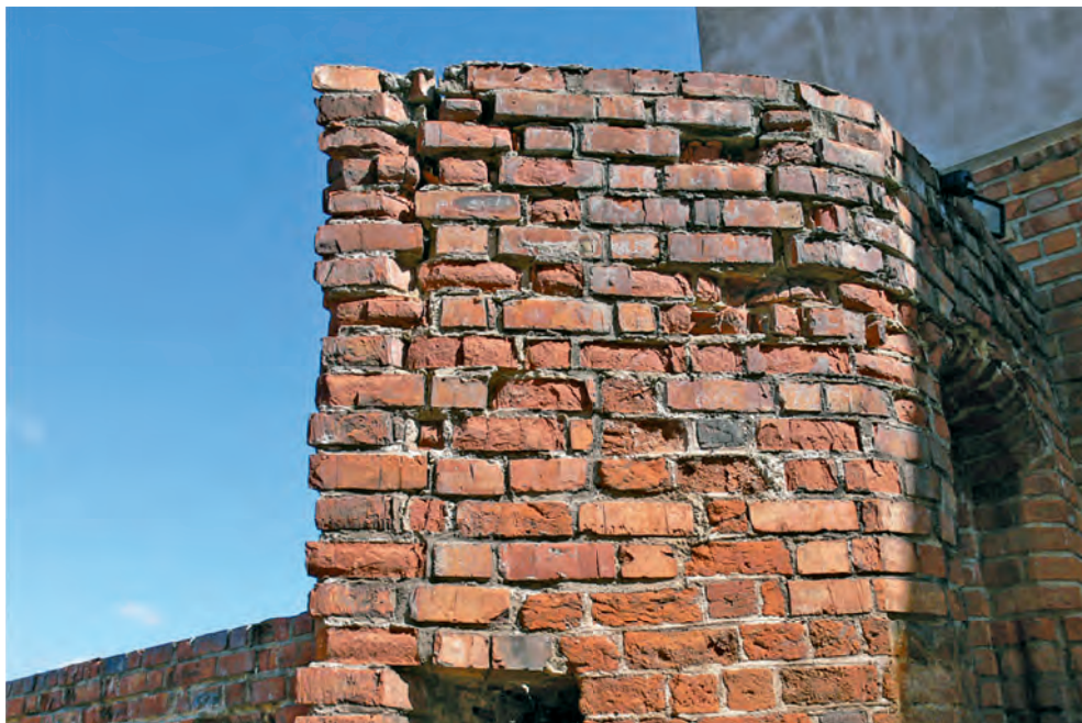
Fot. 10 Niebezpieczne pęknięcia murów na górnym dziedzińcu. Fot. B. J. Rouba
