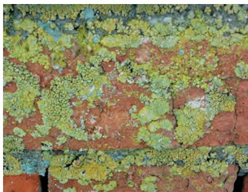
Fot. 5. Nawarstwienia o charakterze biologicznym
