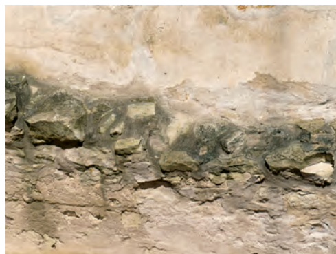
Rys. 12. Korozja solna tynków w murze z kamienia wapiennego
