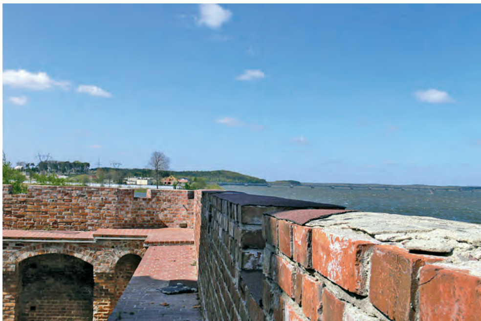
Fot. 9 Założone przed laty prowizoryczne zabezpieczenia korony murów z czasem uległy zniszczeniu, co sprzyja zamakaniu murów i powstawaniu wysoleń. Fot. B. J. Rouba
