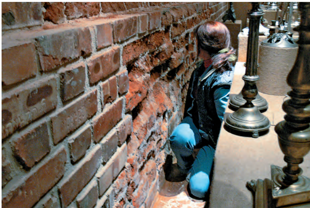
Fot. 16 Na skutek użycia cegły zbyt mało porowatej, zaprawy z dodatkami cementu, nieskutecznej ochrony murów przed wodą – stara cegła odegrała rolę sączka. Fot. B. J. Rouba
