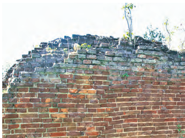
Rys. 1. Zniszczenia korony murów z cegły ceramicznej spowodowane działaniem wód opadowych.
