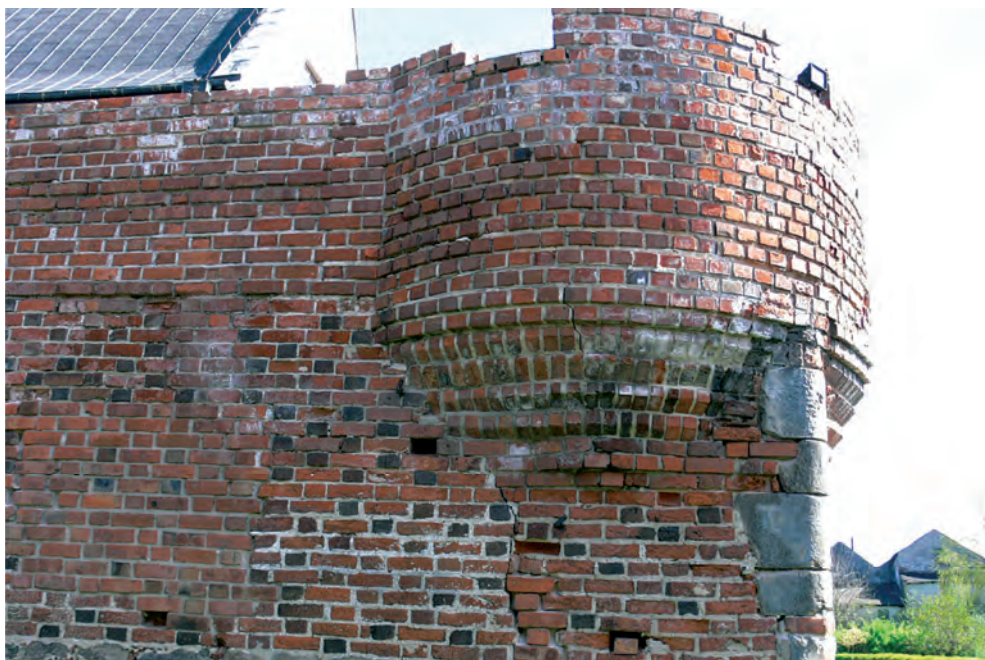
Fot. 7 Pęknięcia murów bastei są głębokie i stwarzają poważne zagrożenie – stan w roku 2007. Fot. B. J. Rouba
