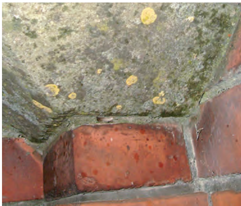
Rys. 14. Rozwój porostów na betonowym zwieńczeniu muru z cegły ceramicznej
