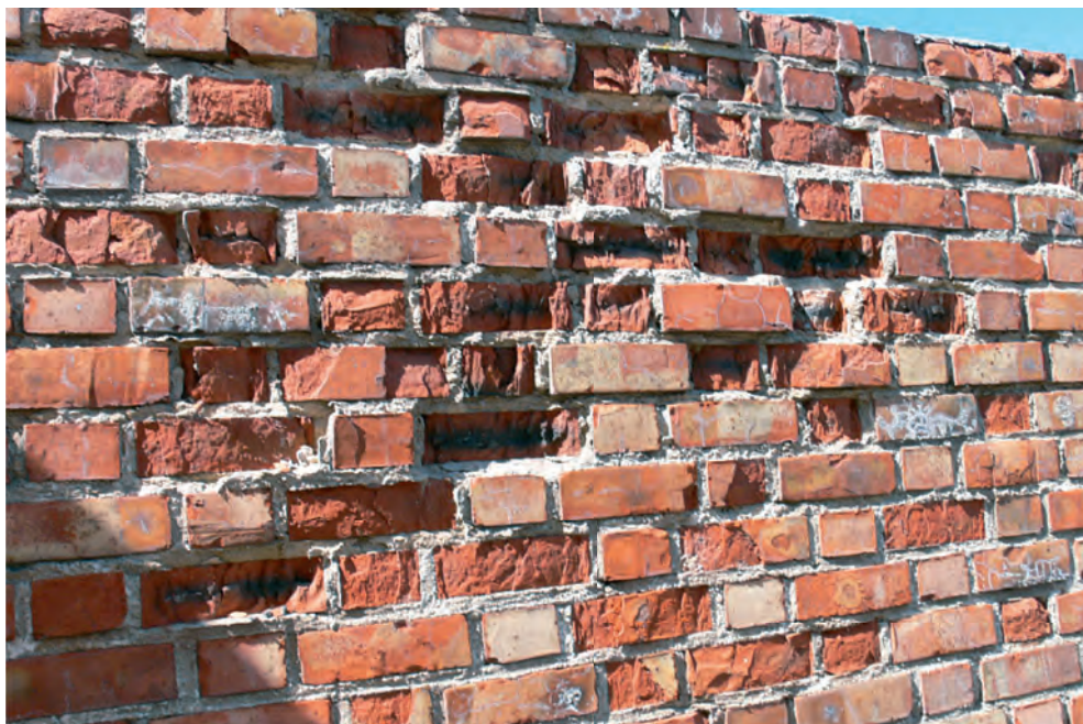
Fot. 11 Stan cegły użytej w latach 80. jest następstwem jej złej jakości. Fot. B. J. Rouba
