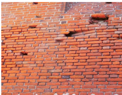
Fot. 6. Dezintegracja cegieł i zapraw pod wpływem soli rozpuszczalnych w wodzie i wody kondensacyjnej
