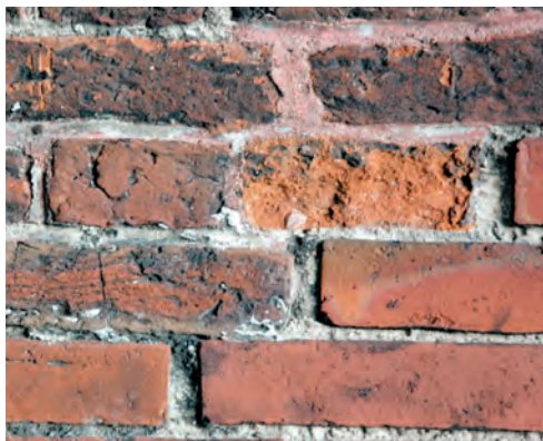
Fot. 9. Dezintegracja oryginalnej cegły w wyniku zastosowania wtórnie cegieł i zapraw o zbyt niskiej porowatości
