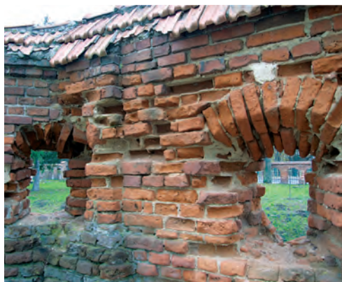
Rys. 10. Widok uszkodzeń muru z cegły ceramicznej w pasie odparowania wody i krystalizacji soli.
