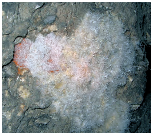
Rys. 7. Korozja solna cegły ceramicznej i zaprawy na powierzchni muru.
