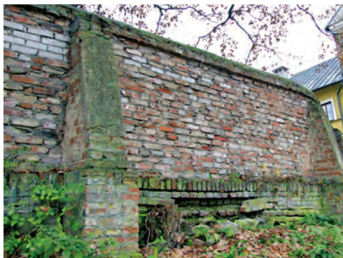
Rys. 3. Przęsło muru z widocznymi uszkodzeniami w paśmie przziemia.
