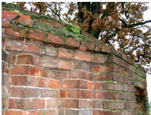
Rys. 4. Fragment muru obronnego z widocznymi uszkodzeniami korony.
