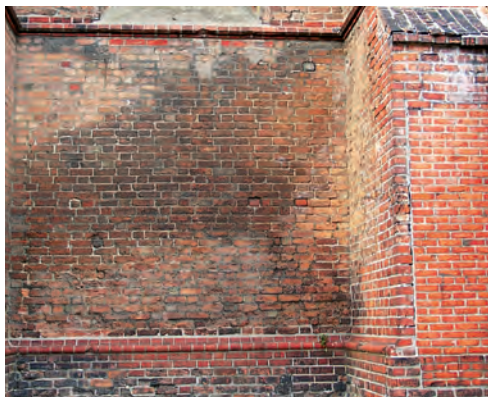
Fot. 7. Dezintegracja materiałów budowlanych pod wpływem wznoszących się kapilarnie wód gruntowych
