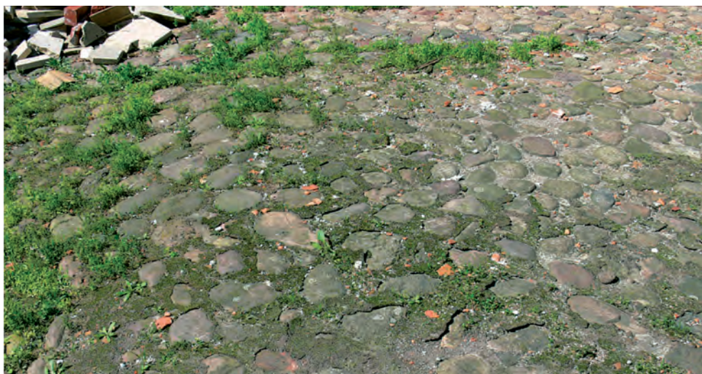
Fot. 5 Uszczelnienie dziedzińców uniemożliwia prawidłowe parowanie wody i zwiększa przez to zawilgocenie murów. Fot. B. J. Rouba
