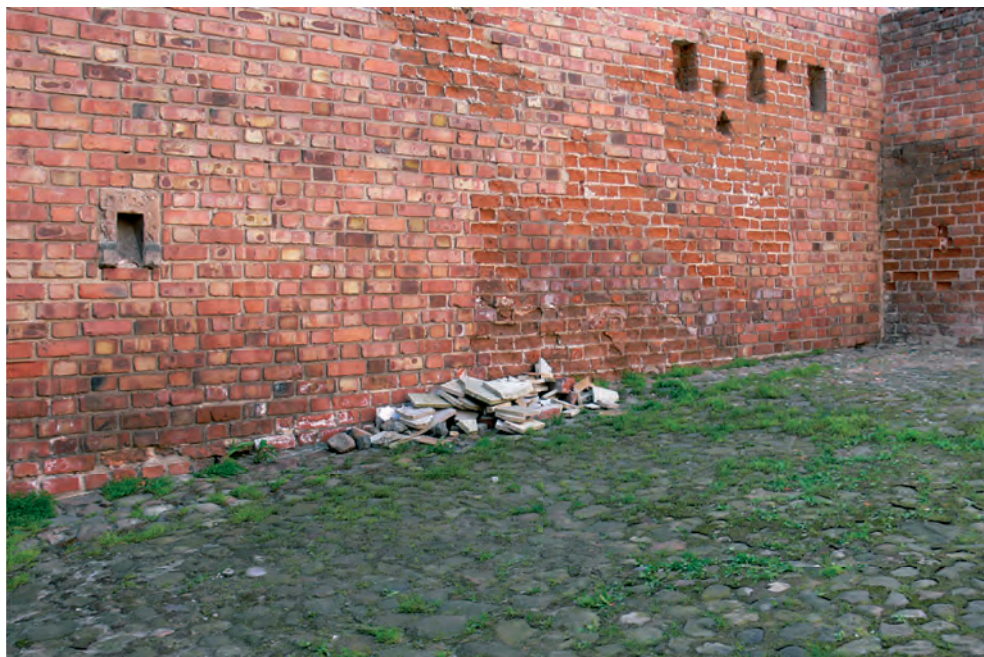
Fot. 13 Brak efektywnego odpływu wody z nierównego dziedzińca „wysokiego” (wewnętrznego) i ułożenie bruku na cementowej zaprawie, to czynniki sprzyjające zawilgoceniu murów i niszczeniu przyziemnej partii. Fot. B. J. Rouba
