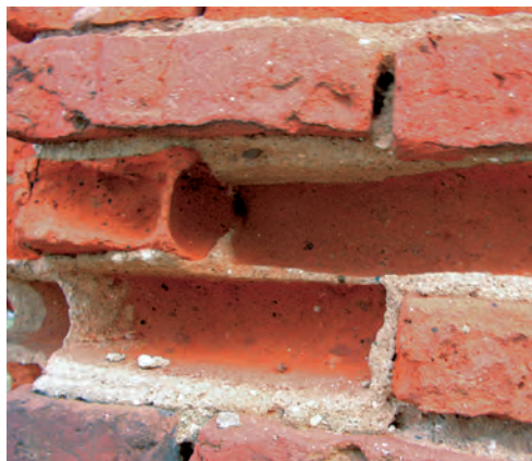
Rys. 8. Korozja solna cegły ceramicznej i zaprawy we wnętrzu porów materiałów.
