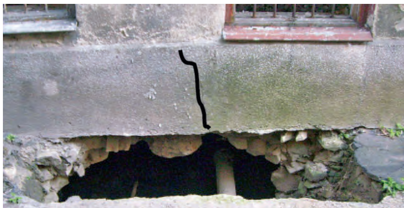
Rys. 5. Rysa – stan równowagi chwiejnej.
