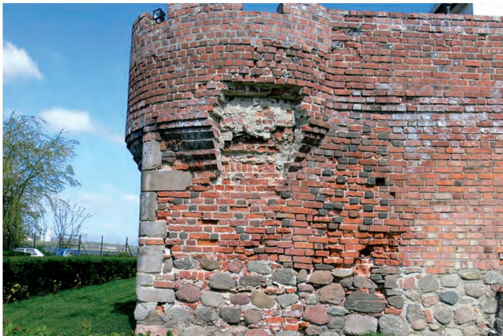
Fot. 6 Uszkodzenia bastei powstałe przede wszystkim na skutek wad wykonawstwa podczas jej rekonstruowania. Fot. B. J. Rouba
