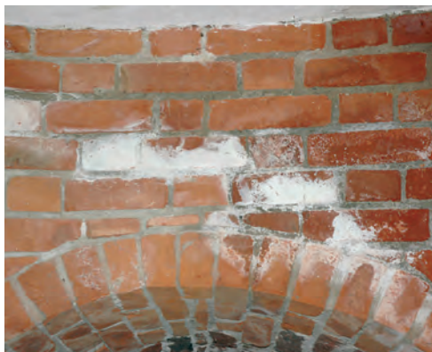
Fot. 8. Działanie soli rozpuszczalnych w wodzie
