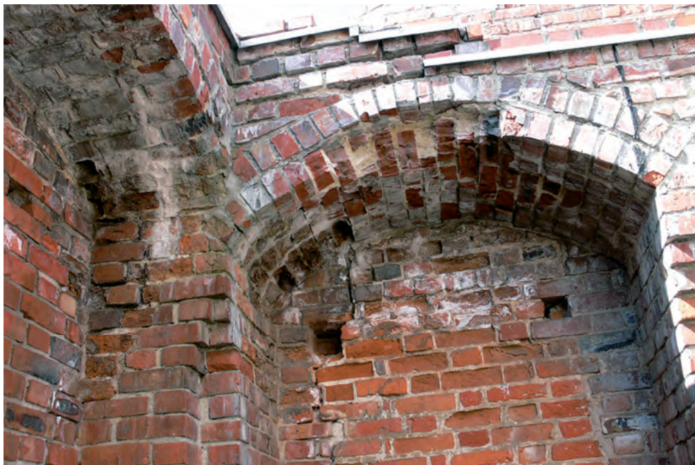
Fot. 8 Widok pękniętej bastei od strony dziedzińca. Fot. B. J. Rouba
