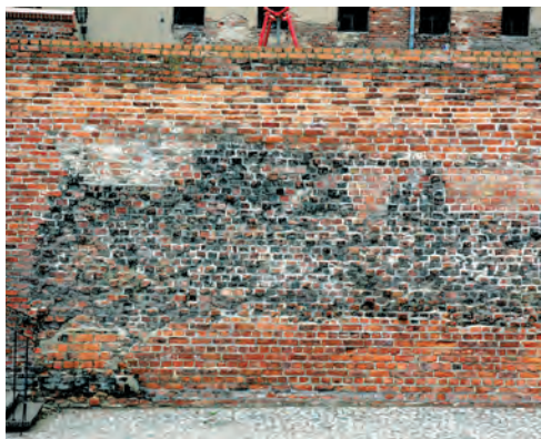
Fot. 10. Dezintegracja oryginalnej cegły w wyniku zastosowania wtórnie cegieł i zapraw o zbyt niskiej porowatości
