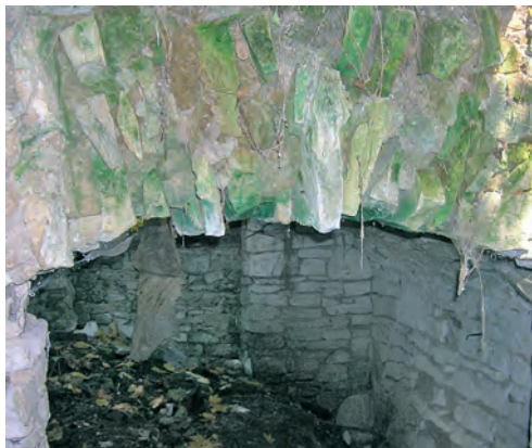
Rys. 13. Kolonie glonów na przewilgoconym murze z cegły ceramicznej
