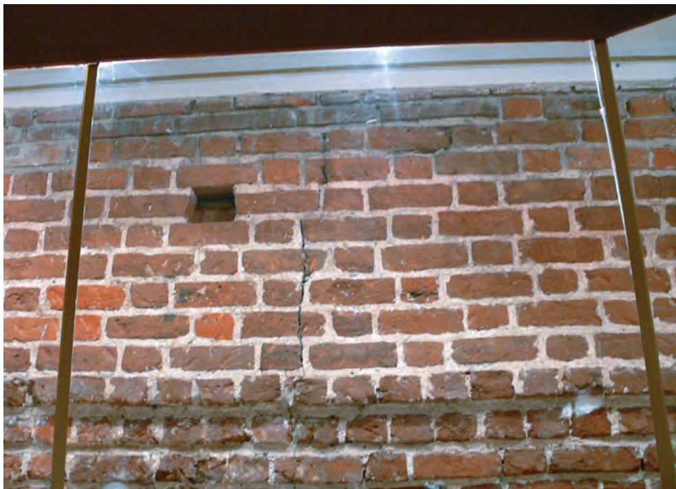
Fot. 14 Głębokie pęknięcie ściany w sali z ekspozycją sprzętu oświetleniowego zapewne także sprzyja dostarczaniu wody w mur. Fot. B. J. Rouba
