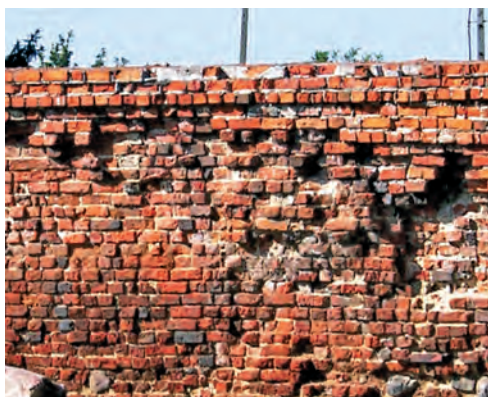
Fot. 11. Dezintegracja oryginalnej cegły w wyniku zastosowania wtórnie cegieł i zapraw o zbyt niskiej porowatości
