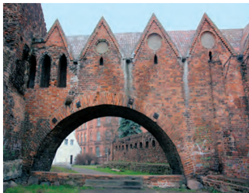
Fot. 1. Szaroczarne nawarstwienia równomiernie pokrywające powierzchnię muru
