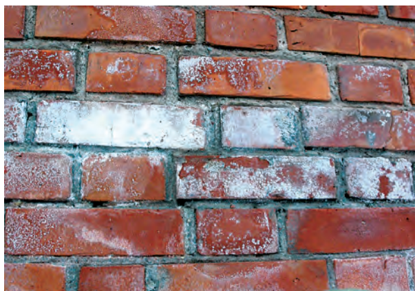
Fot. 14. Wysolenia składające się z gipsu i glinianów wapniowych
