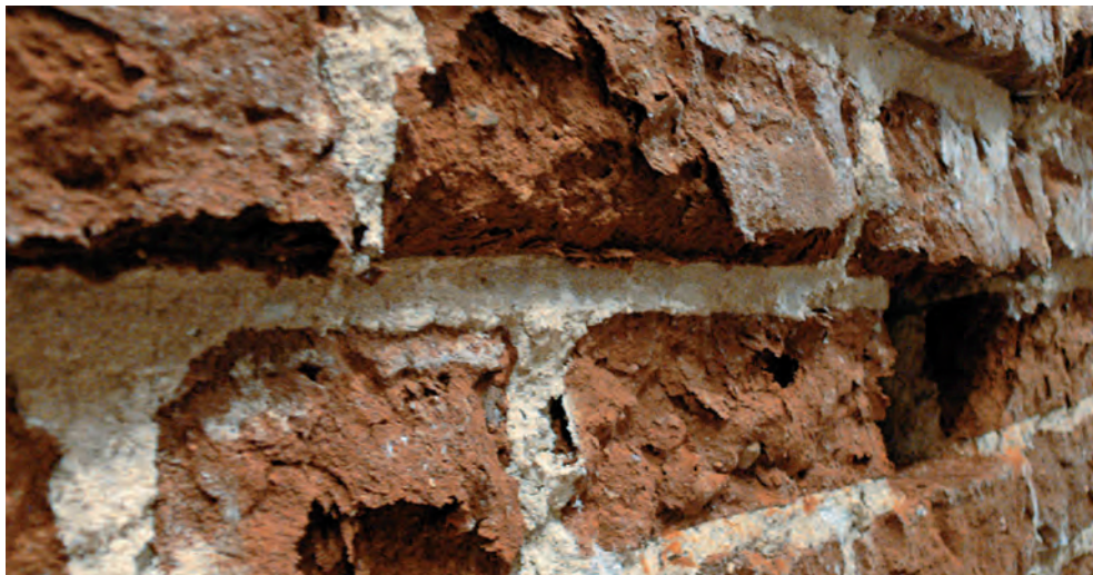
Fot. 18 Destrukcję pogłębiło wykonanie „domowym sposobem” konserwacji cegły mieszanką preparatów sklejących-co-hydrofobizujących. Skutkiem jest odrywanie płatów skleionej ceglanej mączki. Fot. B. J. Rouba
