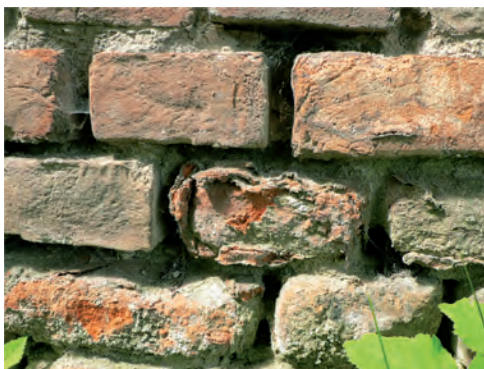
Rys. 11. Korozja solna spoin w murze z cegły ceramicznej.
