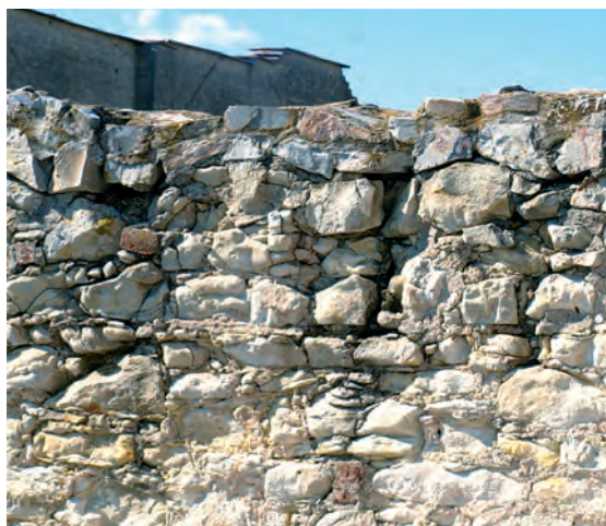
Rys. 2. Zniszczenia korony murów z kamienia spowodowane działaniem wód opadowych.
