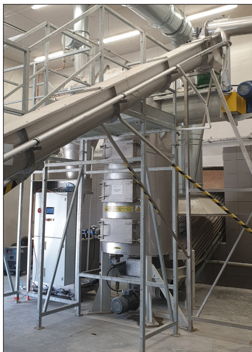
Rys. 7. Fotografia instalacji FuelCal®
