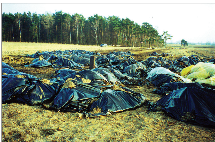
Fot. 8. Usuwanie oleju napędowego z wycieku z rurociągu
