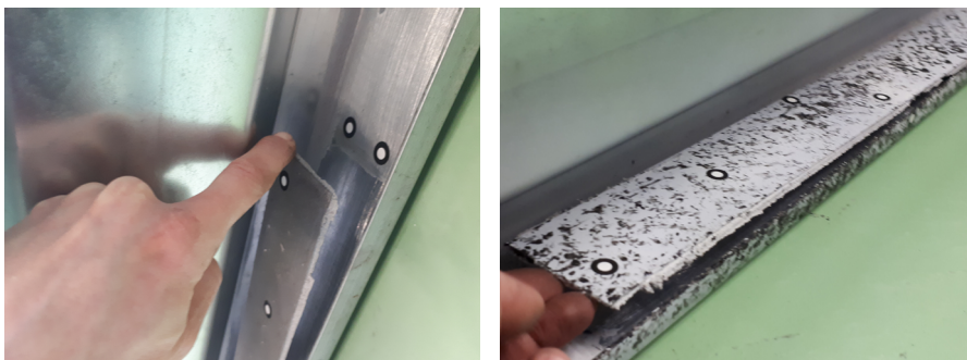
Ryc. 7.27. Odspojenie taśmy stalowej
