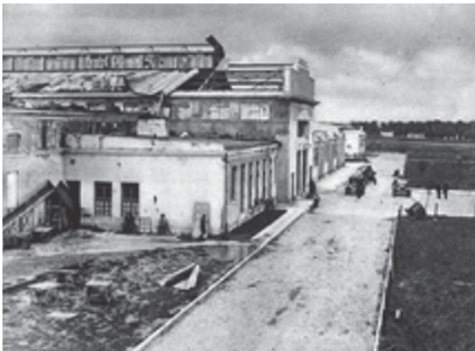
Ryc. 31. Zniszczony przez tornado budynek rzeźni z zerwanym dachem
